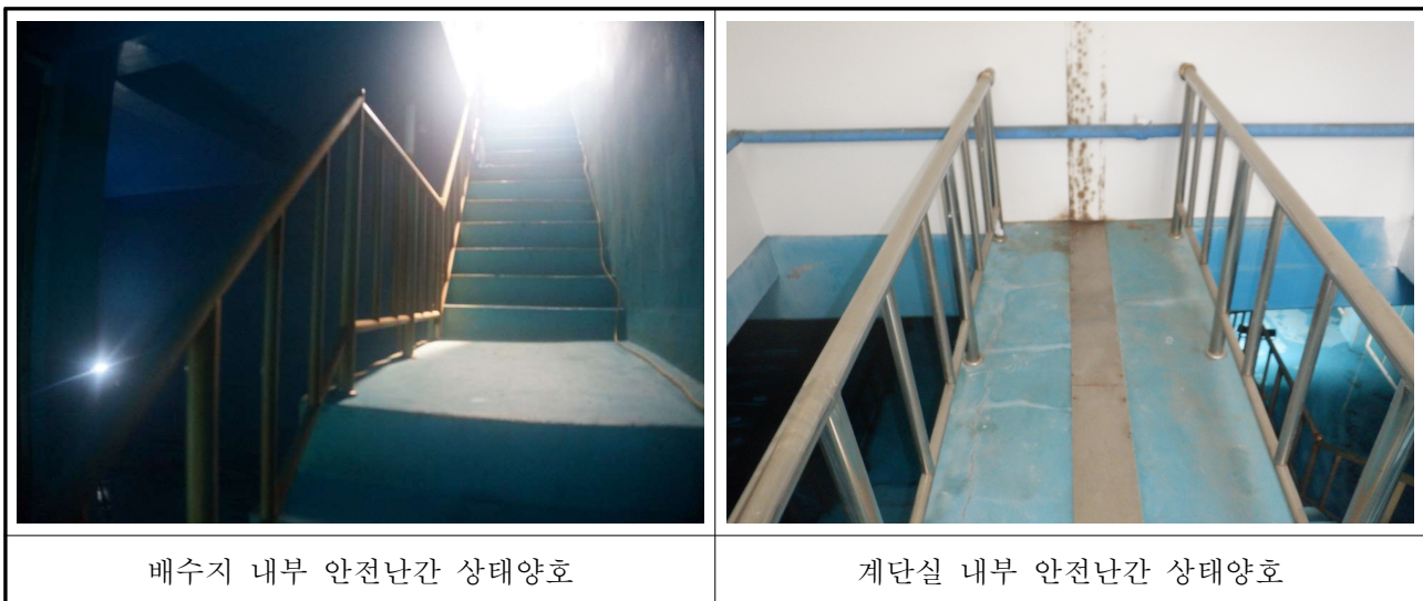
【사진 3.10】 추락방지시설 손상사진
