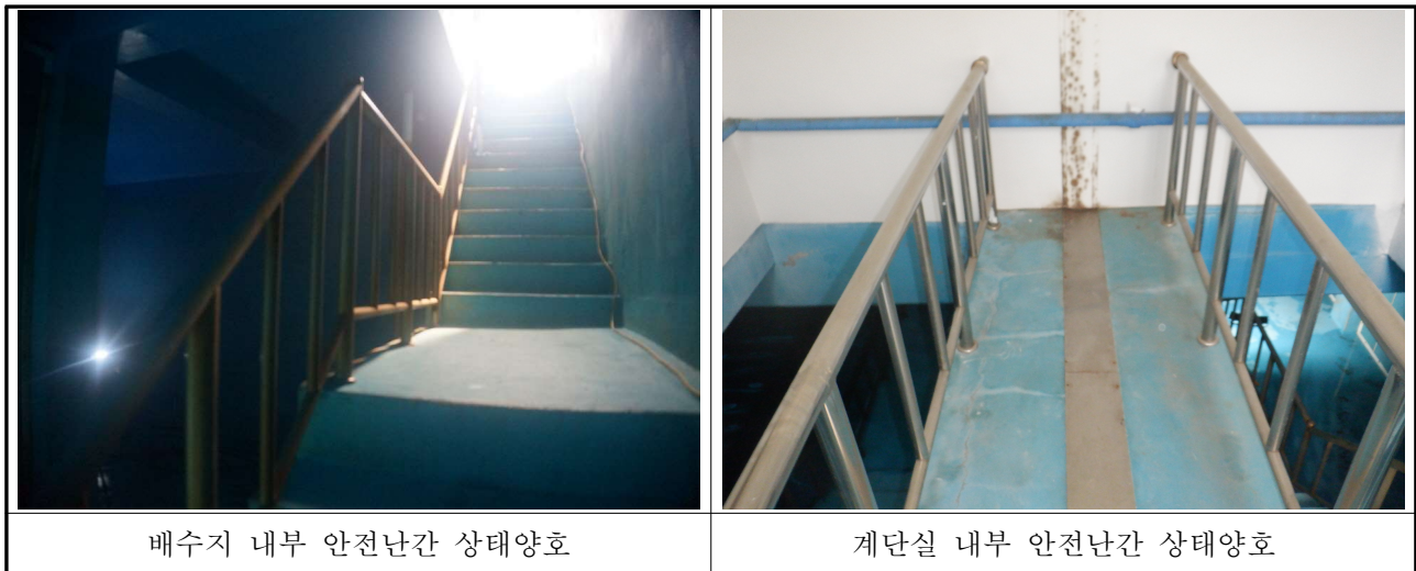
【사진 3.7】 안전시설(점검로) 손상사진
