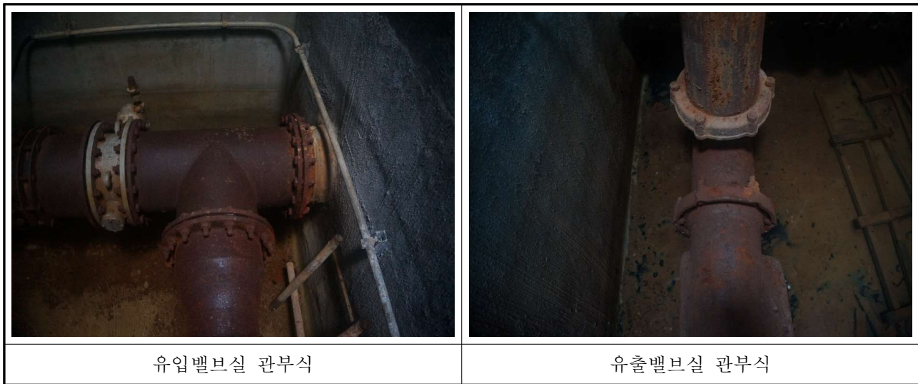
【사진 3.6】 기전설비 손상사진(계속)
